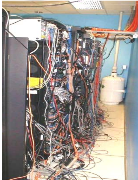
図 3 - 乱雑なケーブル配線の例
