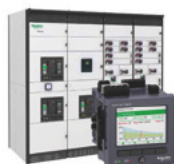
LV Switchgear & Relay (低圧開閉装置)
