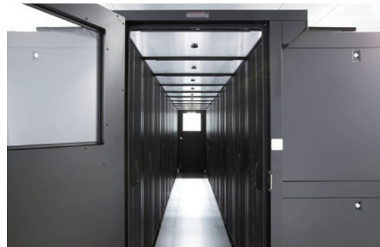
HACS内のホットアイル。高密度機器の排熱が機器前面の吸気口へ廻り込まないように設計されている。
