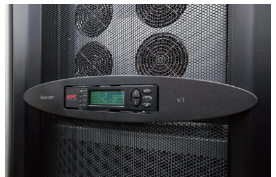
サーバーームに設置されたSmart-UPS VT
