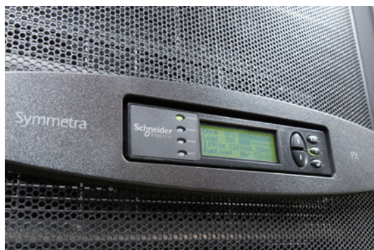
サーバールームに設置されたSymmetra PX
