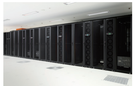
サーバールームに設置されたInfraStruxure InRow RC
