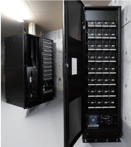
サーバールームに設置されたSymmetra PX 160kW
