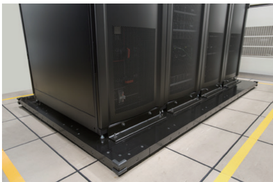
サーバールームに設置されたSymmetra PXとTHK免震装置
