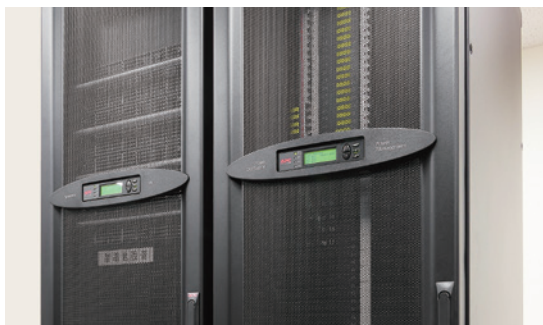
小型UPS 69台をSymmetra PX 1台に 集約しトータルコストの削減を見込む
