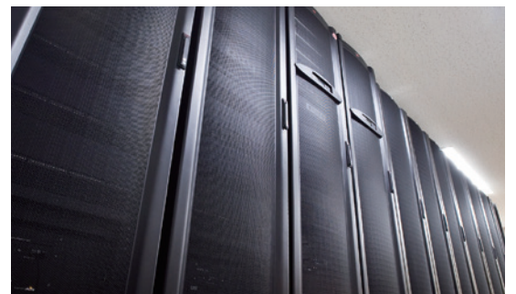
関西大学のサーバールーム
