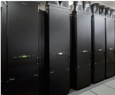
サーバーラックに設置されたAir Removal Unit (ARU)
