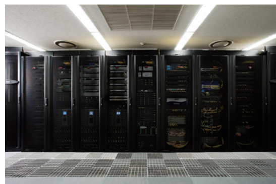
サーバールームに設置されたAPC製品群
