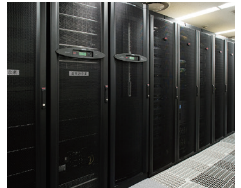
サーバーラックに設置されたSymmetra PX
