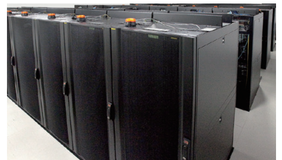
大和ソフトウェアリサーチのサーバールーム
