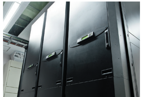
相澤病院のサーバールームに設置されたAir Removable Unit
