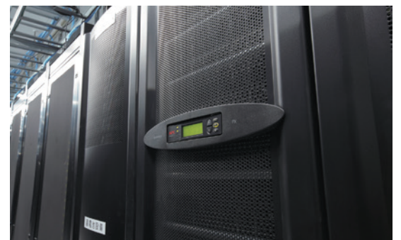
石狩データセンターの段階的な拡張のコンセプトに合致したSymmetra PX160kVA
