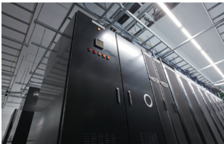
外気冷却をはじめ最先端のテクノロジーを導入することで、PUE1.1台を達成
