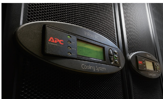
InRow RCによりラック単位で負荷に応じた高効率運転を実現
