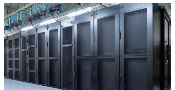
導入されたHot Aisle Containment System (HACS)
