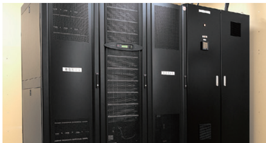
導入されたSymmetra PX 160kVA/160kW
