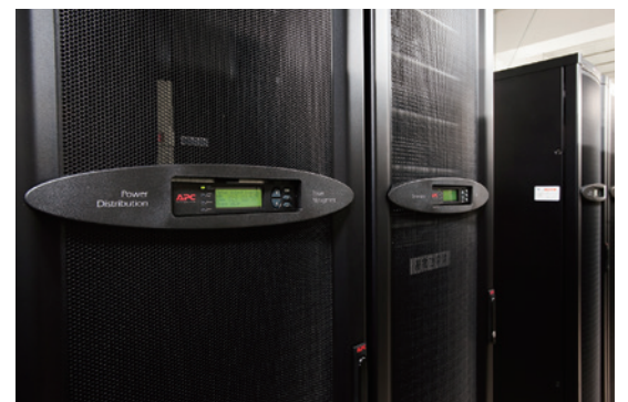
データセンターに設置されたSymmetra PX
