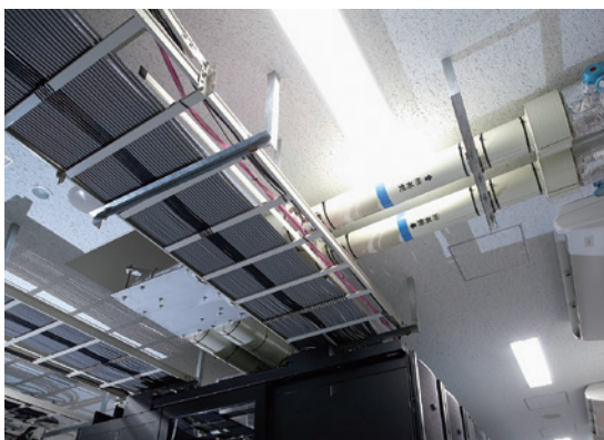
天井に配線を施し運用開始後のシステム変更作業を効率化
