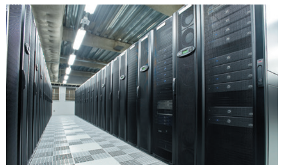
オラクルのサーバールーム
