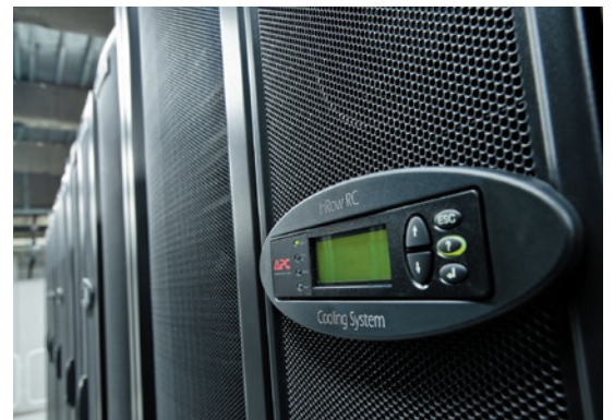
オラクルのサーバールームに設置されたInfraStruXure InRow RC
