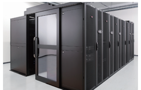
アグレックスのサーバールームに設置されたHACS(引き戸タイプ)
