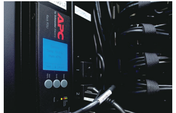
設置されたMetered Rack-Mount PDU
